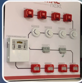
Central de alarme de incêndio 3 fios
