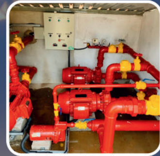
Sistema completo contra incêndio
